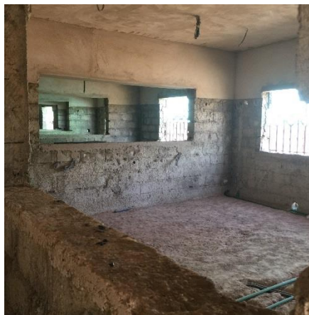
Lavori di costruzione del nuovo reparto di neonatologia dell'Ospedale San Camillo. Esterno ed interno del cantiere.
